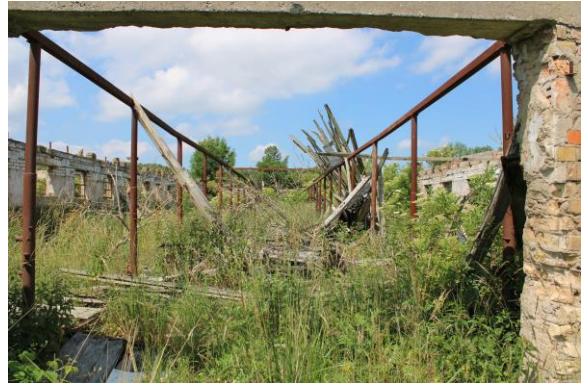
Abbildung 12 Ruine der ehemaligen LPG-Anlage
