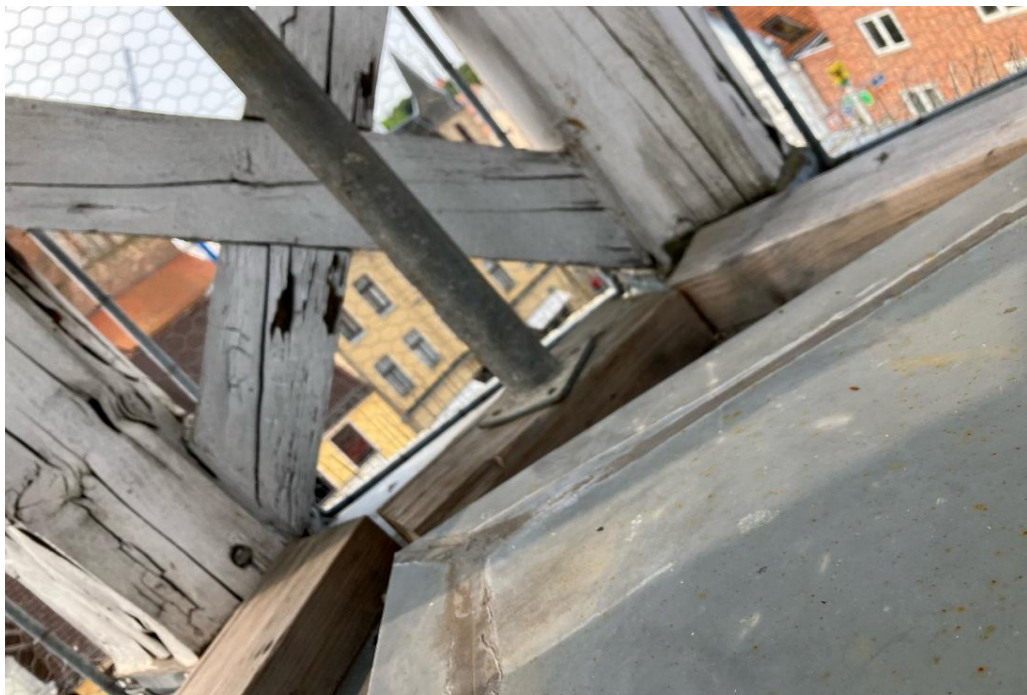
Verfaulte Holzkonstruktion mit Aufsatz Notsteifen
