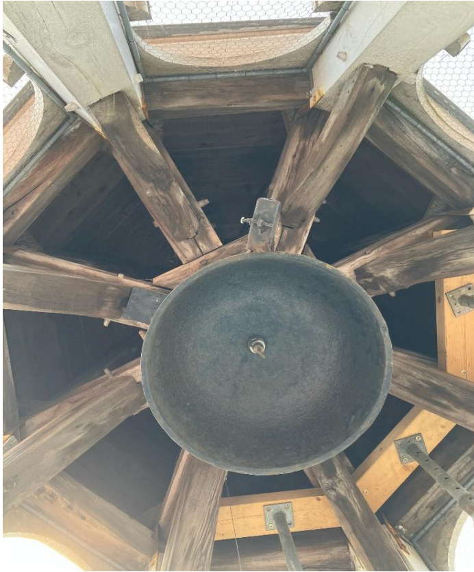
Blick unter die Kuppel mit Notsteifenkonstruktion
