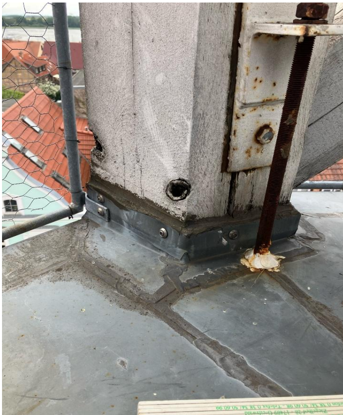
Korrodierte Befestigung Holzstütze
