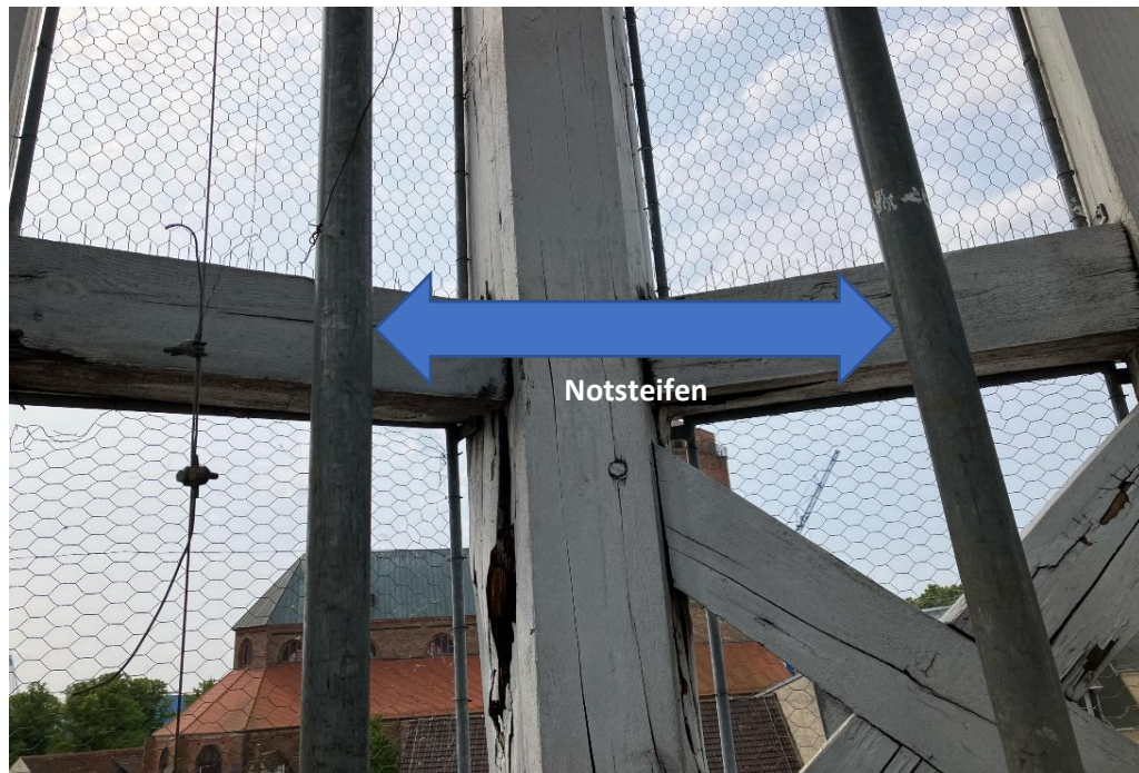
Stark verfaultes Holztragwerk mit Notsteifen
